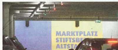
Internes Parkleitsystem - Einzelplatzanzeige (frei/besetzt).
